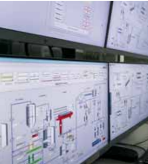
Die Produktionsabläufe in der Stärkefabrik werden von diesem Leitstand aus gesteuert.
