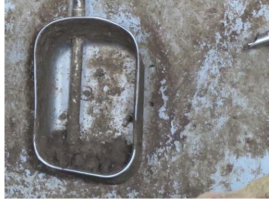
Bild 27: Verschmutzte Beckenrinne (© L. Hagemann / LELF)
