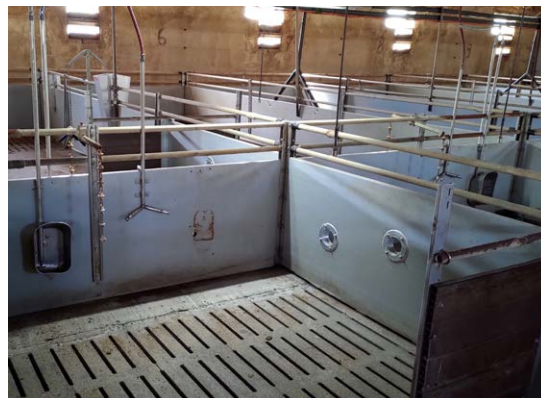
Bild 21: Kotecke mit Blick hinter die Trennwand (rechts) und der Beleuchtung (© J. Schäler / LELF)
