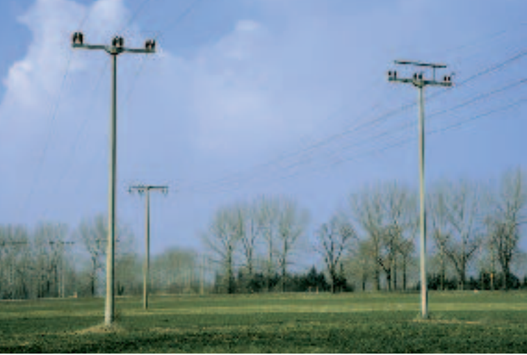
Unterschiedliche Mittelspannungsmasten: Links gesicherte Stützisolatoren, Mitte ungefährliche hängende Isolatoren, rechts suboptimale Sicherung Foto: Uwe Albrecht
